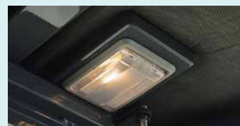
Éclairage intérieur de cabine
