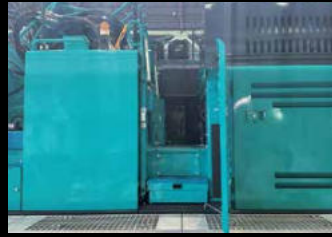
2 Passerelle de maintenance Une large passerelle sécurisée facilite l'accès aux points de contrôle et d'entretien en milieu de tourelle.
